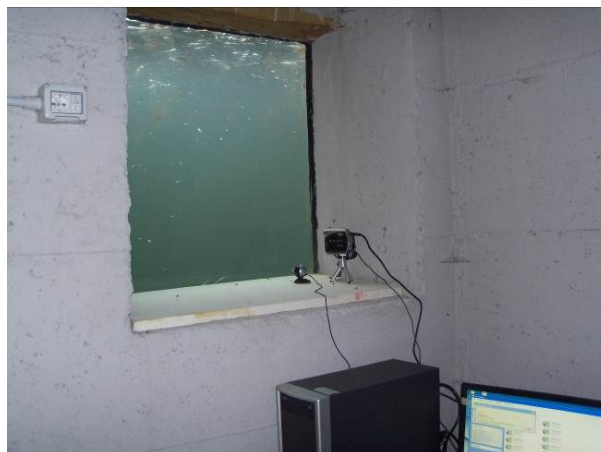
Figura 9-28 La cabina di monitoraggio del passaggio per pesci dello sbarramento del Panperduto.
